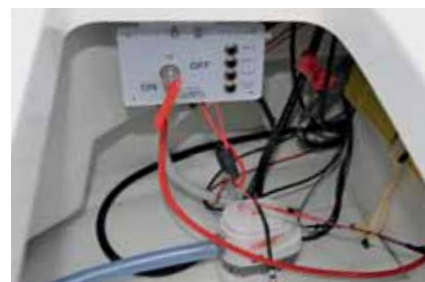
Technické zázemí s čerpadlem, akumulátorem a odpojovačem akumulátoru je umístěno pod lavicí řidiče.
